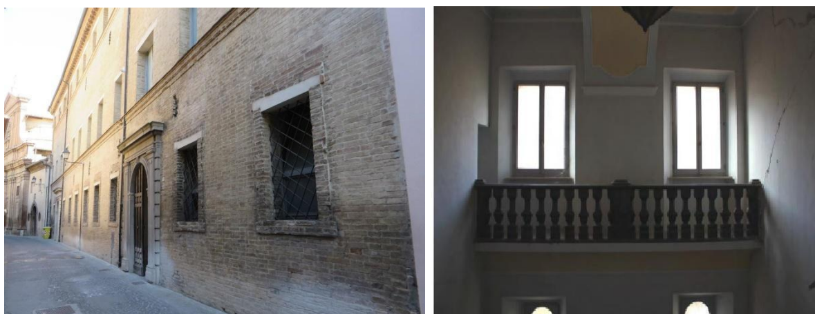
Fronte strada dell'edificio e alcuni danni interni
